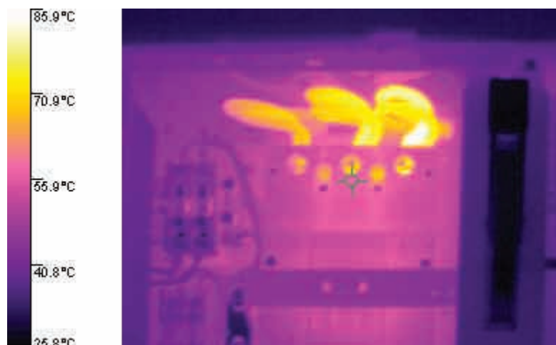
MCC（モーター制御センター）の温度が高くなっている接続部分
