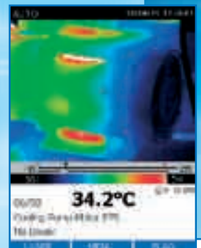
コンプレッサー稼働中の温度
